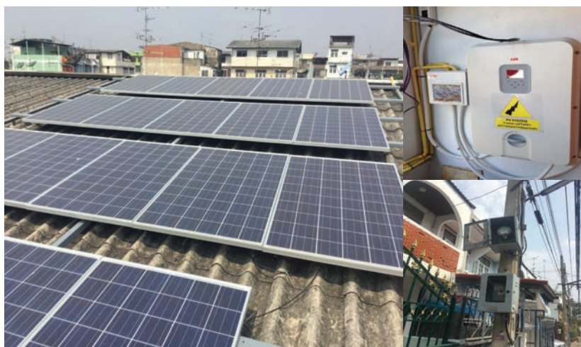
โครงการผลิตไฟฟ้าแสงอาทิตย์บนหลังคาบ้าน
